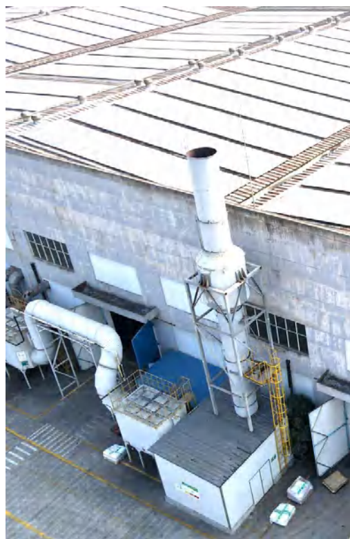
合兴厂区废气处理装置
