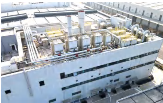
锦丰新厂废气处理装置
